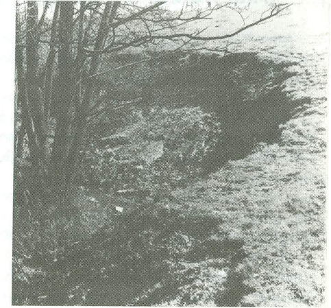
Uferabbruch am Kiffenbrinkbach. Foto: J. Rehm
